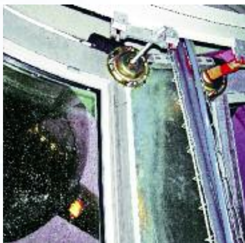
Fig. 19: För att förhindra galvanisk korrosion har infästningen av panelen av rostfritt stål mot den inre stommen av kolstål gjorts inom fukt fria områden.
